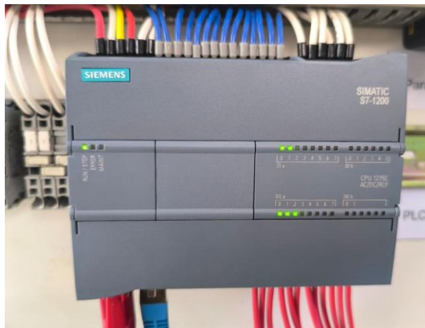
Figura N°5.2: Luces indicadoras en PLC S7-1200
