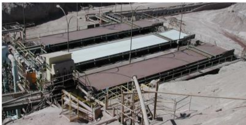
Figura 2.7 Filtros de banda rígida instalados en una mina de cobre en Anglo American en Chile (Wills, 1997).
