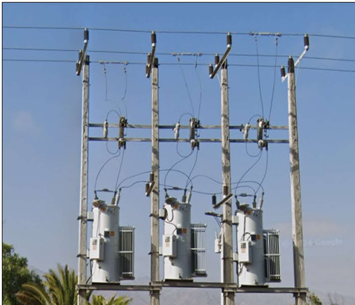
Figura 5.4: Regulador de Tensión Instalado
