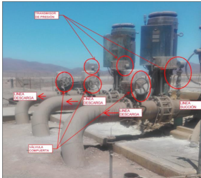
Figura N°3.3: Zona de medición de curvas de operación bombas verticales.
