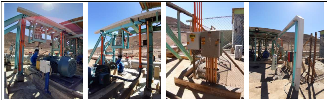
Figura N°4.16: Tableros eléctricos en instalación booster.
