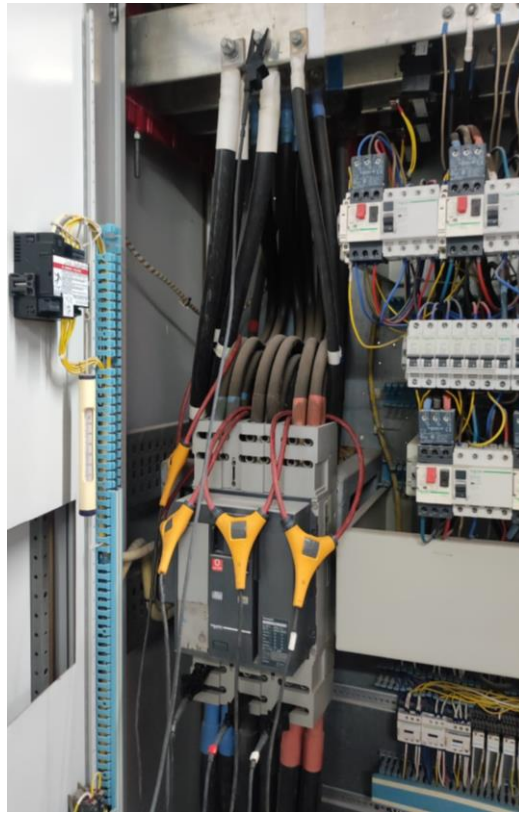
Figura 3.6 Conexión de pinzas amperimétricas y pinzas de tensión en el breaker principal de la sala eléctrica N°1.
