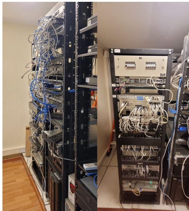
Figura 5.1: Armario de distribución y rack de telefonía.
