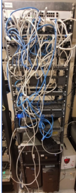
Figura 5.2: Rack de datos.
