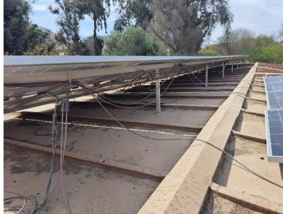
Figura N° 5.4: Conexiones en el lado posterior de los módulos fotovoltaicos.
