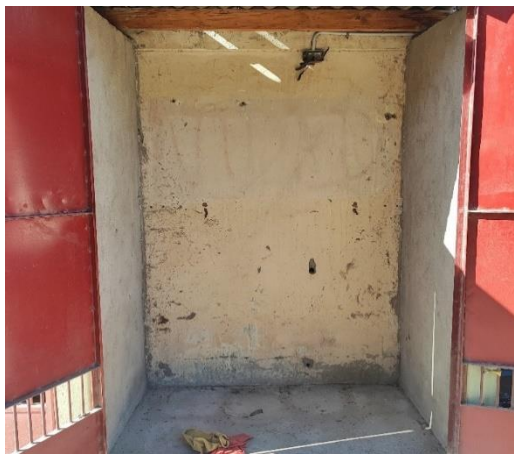
Figura N° 5.14: Bodega de almacenamiento con necesidad de mejoras Fuente: Elaboración propia.
