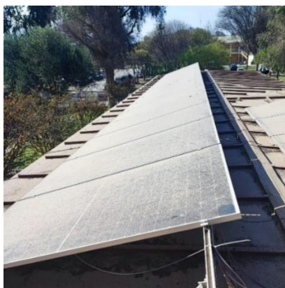
Figura N° 3.1: Suciedad presente en toda la instalación.
