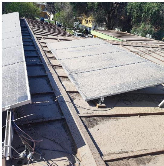
Figura N° 3.2: Módulos fotovoltaicos con abundante polvo en su superficie.
