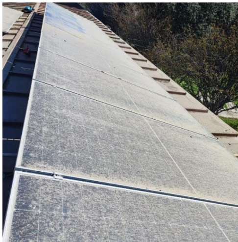
Figura N° 5.1: Módulos fotovoltaicos antes de limpieza.
