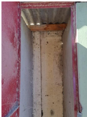
Figura N° 5.6: Suciedad dentro de la bodega.
