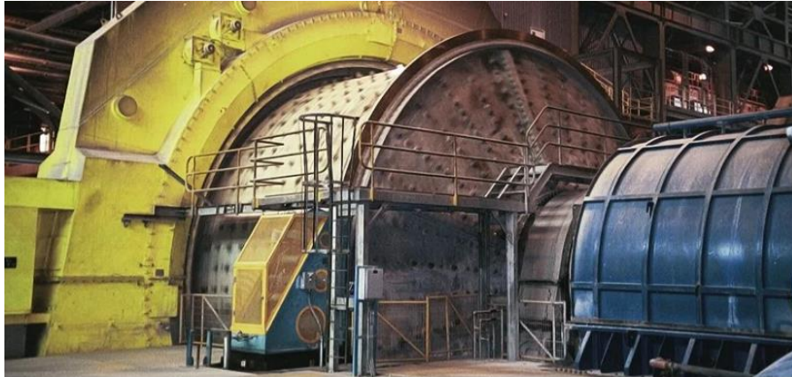
Fig. 2.5 Vista panorámica de un molino SAG
