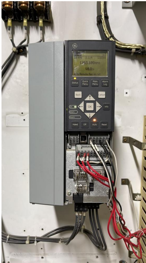
Fig. 2.4 Variador de frecuencia
