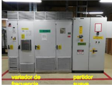
Variador de frecuencia con el partidor suave
