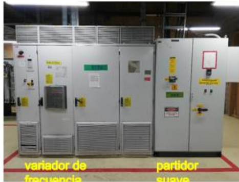
Variador de frecuencia con el partidor suave
